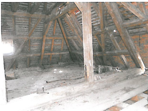
Fot. 31 – Widok na zniszczoną obsuniętą konstrukcję więźby dachowej wraz z połącią dachową i widoczne dziury w pokryciu dachowym.
