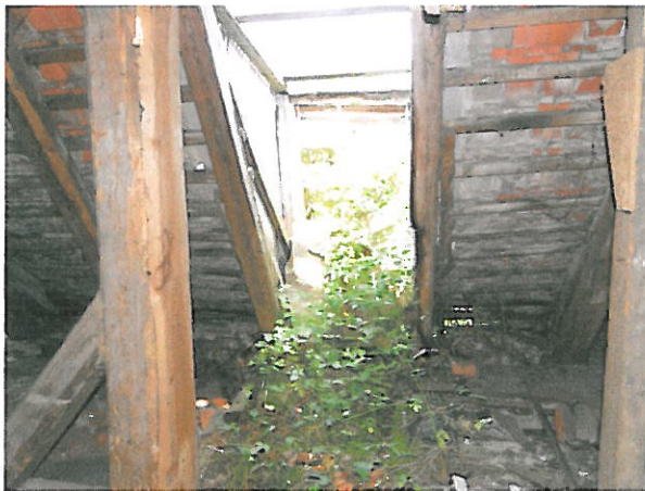
Fot. 18 – Zniszczone i powycinane elementy więzby dachowej i stropu w miejscu niezabezpieczonym po wyciągu w budynku Nr G.
