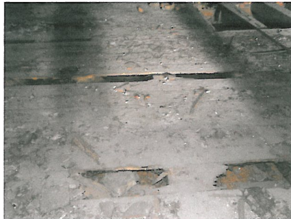
Fot. 25 – Widok na zniszczoną podłogę drewnianą na strychu w budynku Nr 1.
