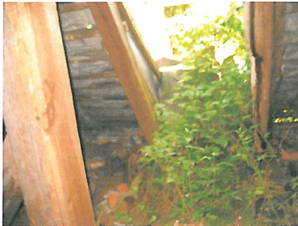
Fot. 35 – Zniszczone elementy więźby dachowej i stropu w miejscu wyciętej niezabezpieczonej połaci dachowej w budynku Nr G.
