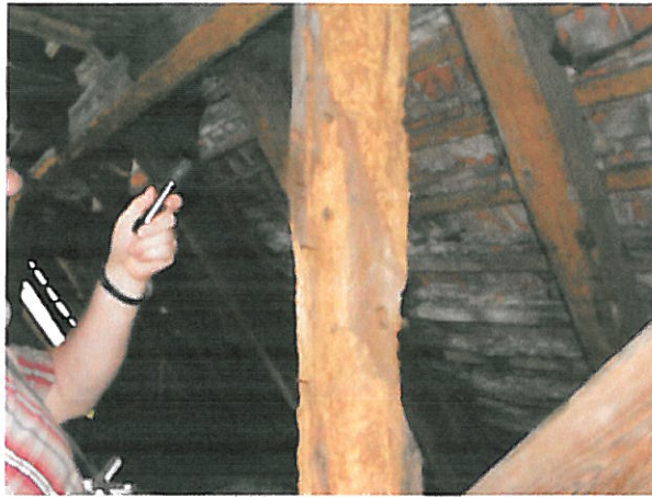
Fot. 17 – Zniszczony biologicznie słup drewniany więzby dachowej w budynku Nr G.
