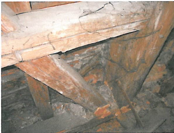
Fot. 42 – Widoczny grzyb na elementach więźby w budynku Nr 1.
