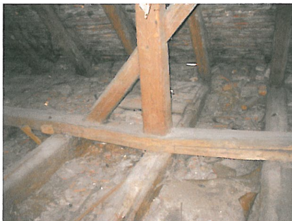
Fot. 36 – Obniżenie zniszczonego stropu więźby dachowej w miejscu dziurawego dachu w budynku Nr G.
