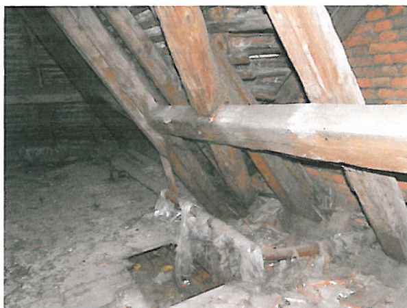
Fot. 30 – Widok na zniszczone końcówki podparcia więźby.
