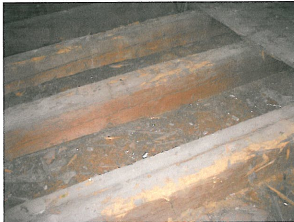
Fot. 40 – Belki stropowe powierzchniowo skorodowane w budynku Nr 1.
