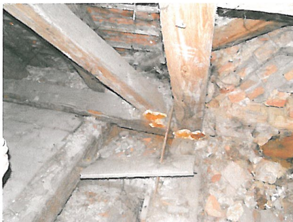
Fot. 29 – Zagrzybione elementy więźby dachowej.
