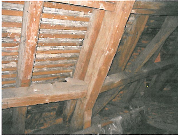
Fot. 41 – Załamanie więźby dachowej w budynku Nr 1 przy ścianie z budynkiem Nr G.
