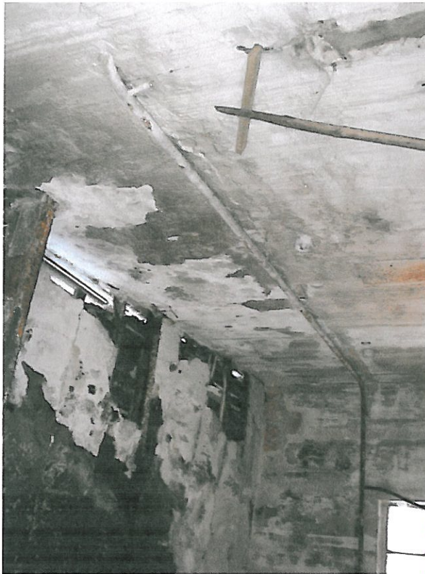
Fot. 6 – Uszkodzony strop w budynku Nr G.
