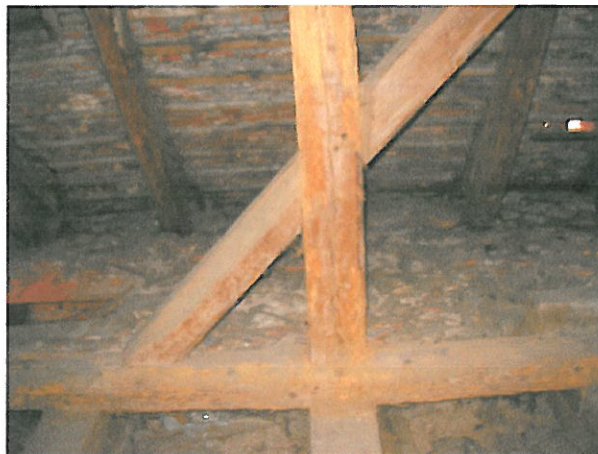
Fot. 33 – Biologiczne zniszczone elementy więźby dachowej w budynku Nr G.
