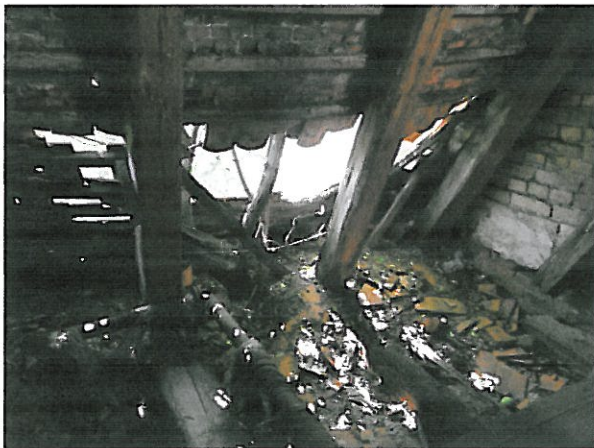
Fot. 19 – Widok na fragment załamanego dachu ze zniszczoną połacią, krokwiemi, murlatą i belkami stropowymi w budynku Nr G.
