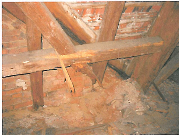
Fot. 39 – Widok na zniszczoną biologicznie więźbę dachową w budynku Nr 1.
