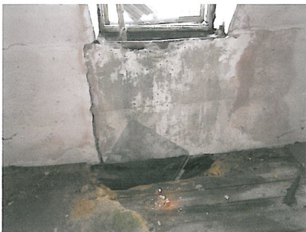
Fot. 16 – Widok na zniszczony strop pod oknem zniszczonym w budynku Nr G.
