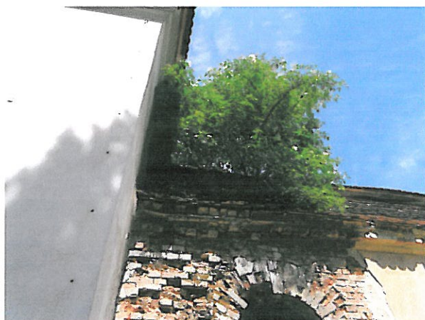
Fot. 13 – Zniszczony mur z łękiem i dach na którym rosną drzewa w budynku Nr G.
