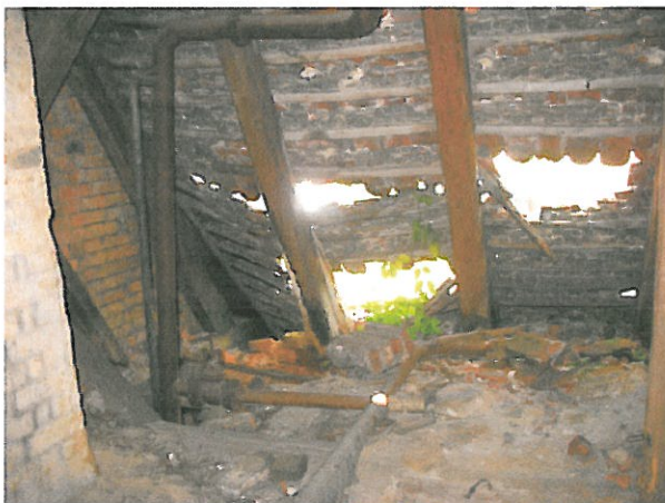
Fot. 37 – Zniszczona połać dachowa wraz z pokryciem i konstrukcją więźby dachowej w budynku Nr G w pobliżu budynku Nr 1.
