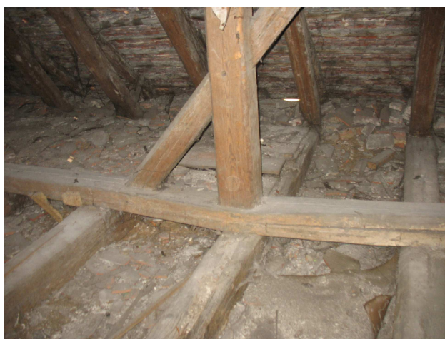
Fot. 36 – Obniżenie zniszczonego stropu więźby dachowej w miejscu dziurawego dachu w budynku Nr G.
