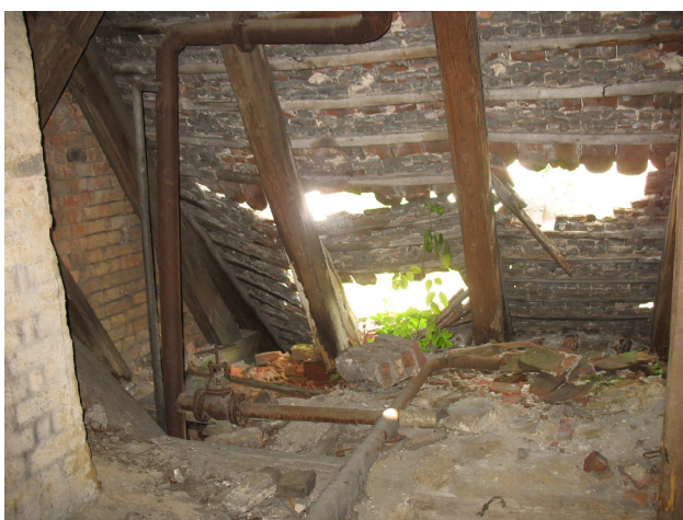
Fot. 37 – Zniszczona połać dachowa wraz z pokryciem i konstrukcją więźby dachowej w budynku Nr G w pobliżu budynku Nr 1.
