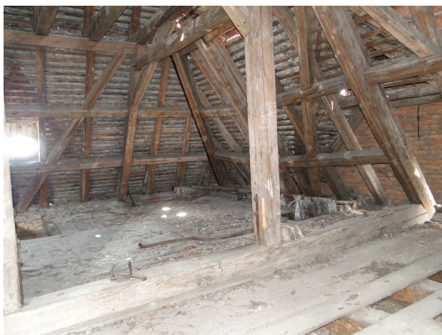
Fot. 31 – Widok na zniszczoną obsuniętą konstrukcję więźby dachowej wraz z połacią dachową i widoczne dziury w pokryciu dachowym.
