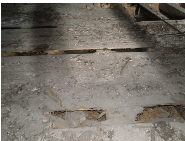
Fot. 25 – Widok na zniszczoną podłogę drewnianą na strychu w budynku Nr 1.
