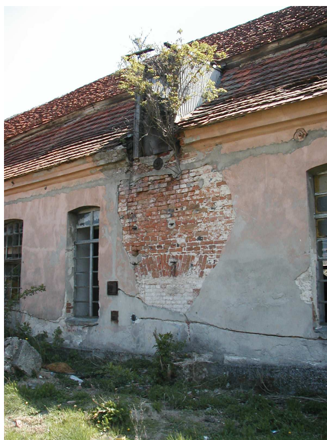
Fot. 5 – Uszkodzony dach w budynku Nr G z rosnącymi na dachu drzewami.
