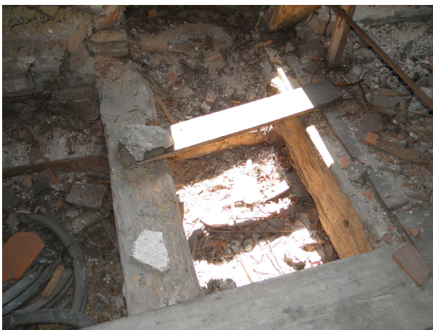
Fot. 22 – Zniszczone belki stropowe i murlata widoczne przy okienku dachowym w budynku Nr G.
