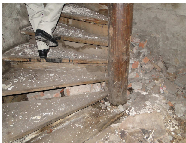
Fot. 15 – Schody kręte drewniane prowadzące na strych w budynku Nr G ( zniszczone ).
