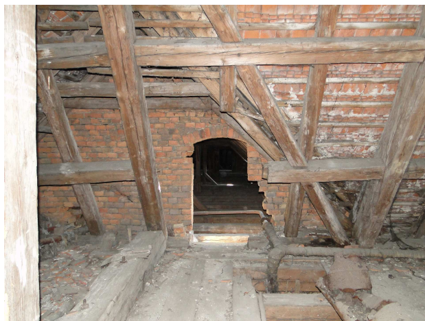
Fot. 28 – Wycięte dla rury elementy więźby, zniszczone podparcie łuku na przejściu między budynkami.
