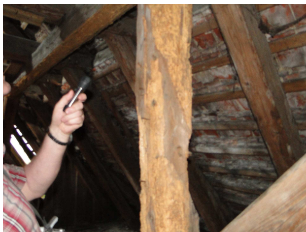
Fot. 17 – Zniszczony biologicznie słup drewniany więźby dachowej w budynku Nr G.
