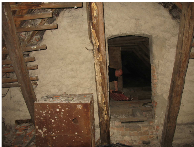
Fot. 32 – Zagrzybiona konstrukcja więźby dachowej w budynku Nr G.
