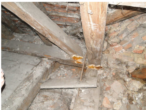
Fot. 29 – Zagrzybione elementy więźby dachowej.
