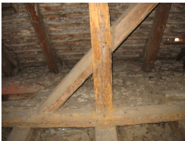
Fot. 33 – Biologicznie zniszczone elementy więźby dachowej w budynku Nr G.
