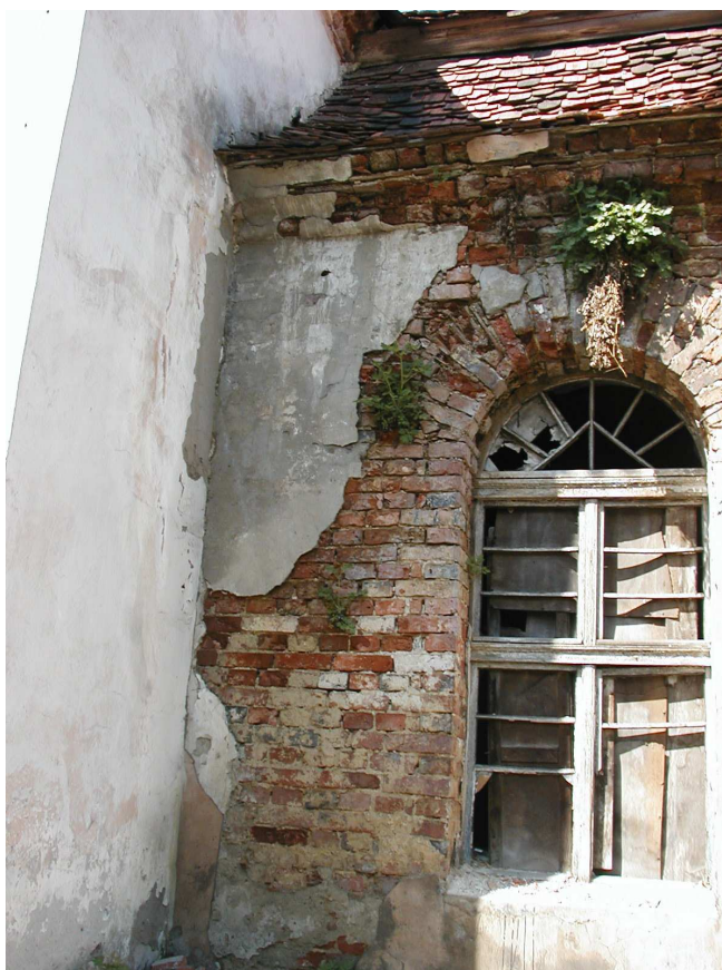
Fot. 7 – Zniszczony fragment muru nad oknem budynku Nr G przy budynku Nr 1.
