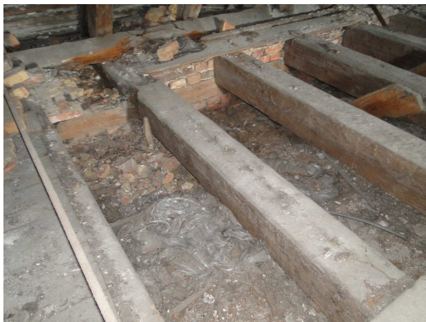
Fot. 26 – Widok na zniszczoną murłatę, końce belek i krokwi w budynku Nr 1.
