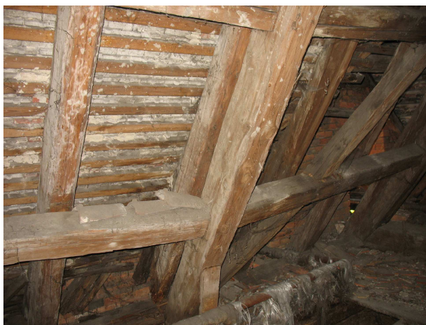
Fot. 41 – Załamanie więźby dachowej w budynku Nr 1 przy ścianie z budynkiem Nr G.
