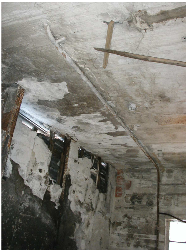
Fot. 6 – Uszkodzony strop w budynku Nr G.
