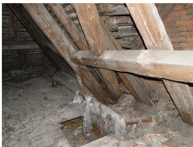
Fot. 30 – Widok na zniszczone końcówki podparcia więźby.
