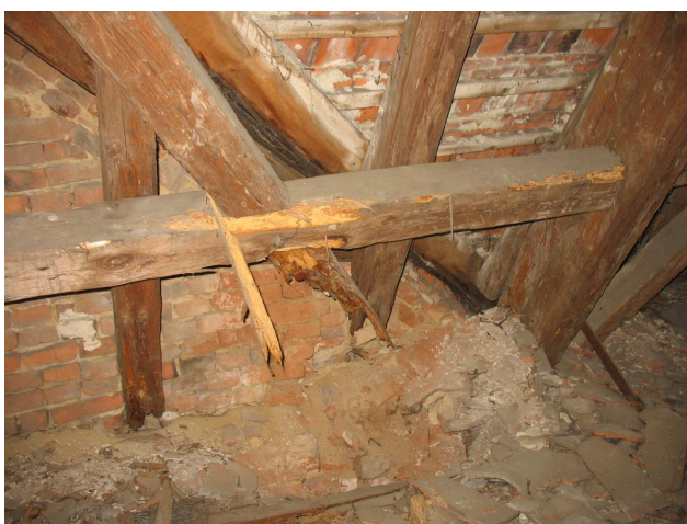
Fot. 39 – Widok na zniszczoną biologicznie więźbę dachową w budynku Nr 1.
