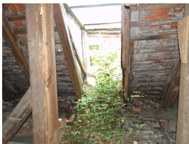
Fot. 18 – Zniszczone i powycinane elementy więźby dachowej i stropu w miejscu niezabezpieczonym po wyciągu w budynku Nr G.
