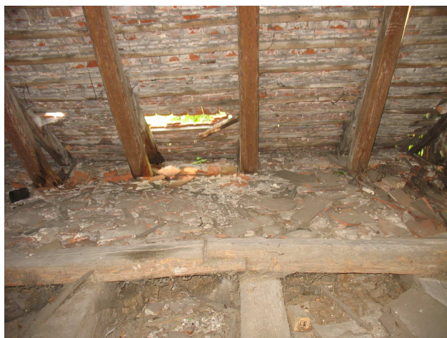
Fot. 34 – Widoczne dziury w pokryciu dachowym i zniszczone końcówki krokwi i nadbitek krokwiowych z murłatą w budynku Nr G.
