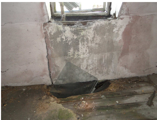
Fot. 16 – Widok na zniszczony strop pod oknem zniszczonym w budynku Nr G.
