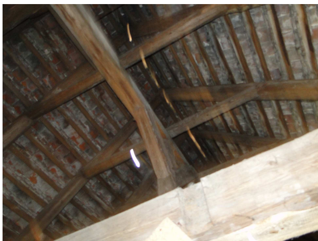
Fot. 20 – Górny fragment więźby dachowej zamoknięty z widocznymi prześwitami w pokryciu dachowym w budynku Nr G.
